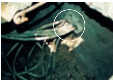
Figura 2: Interior de la arqueta (ver conductos pasacables)
