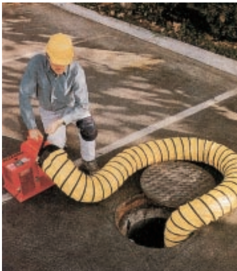
Ventilación general de un pozo de registro
