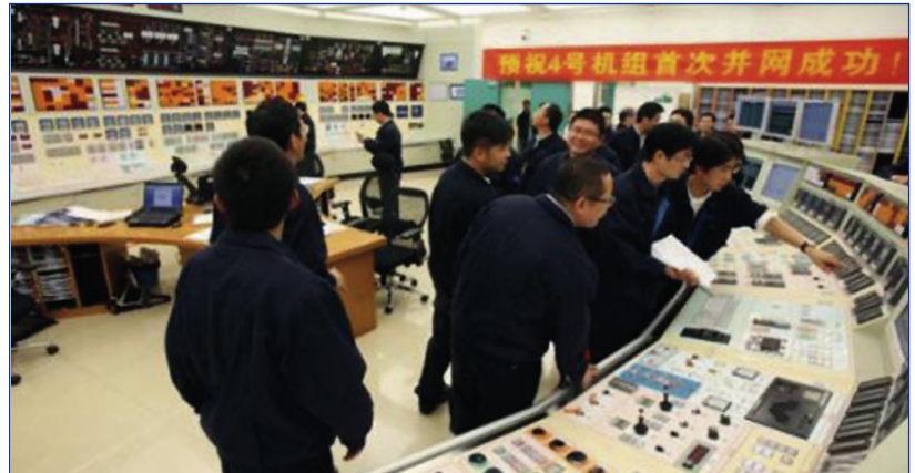
Conexión de la unidad 4 de Qinshan en la sala de control (Foto: WNN)
