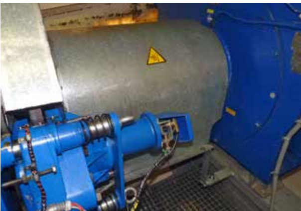
Figura 2. Resguardo de protección acoplamiento alta velocidad.
