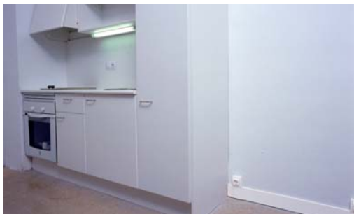
Toma de corriente en cocina.
