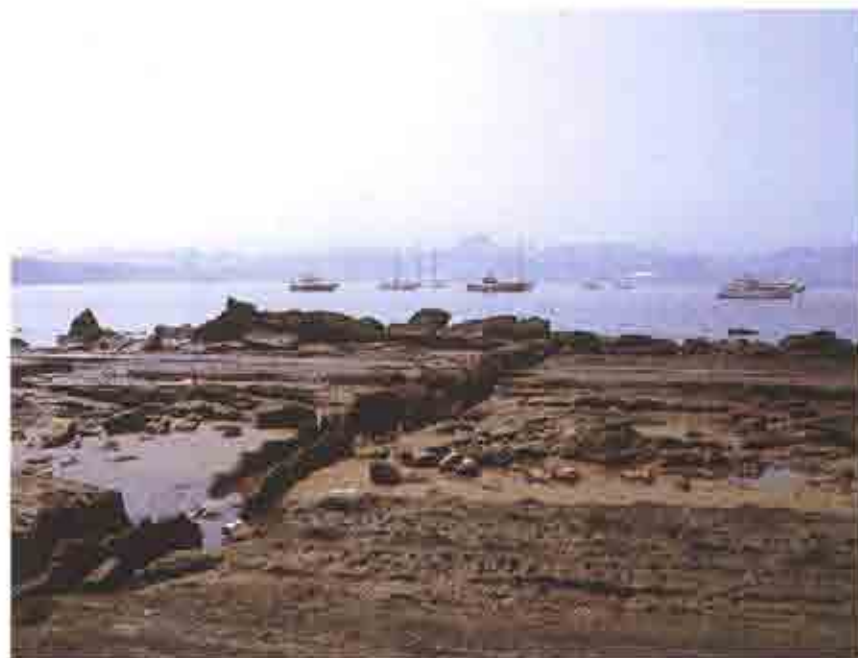
Emisario submarino roto por la acción del oleaje
