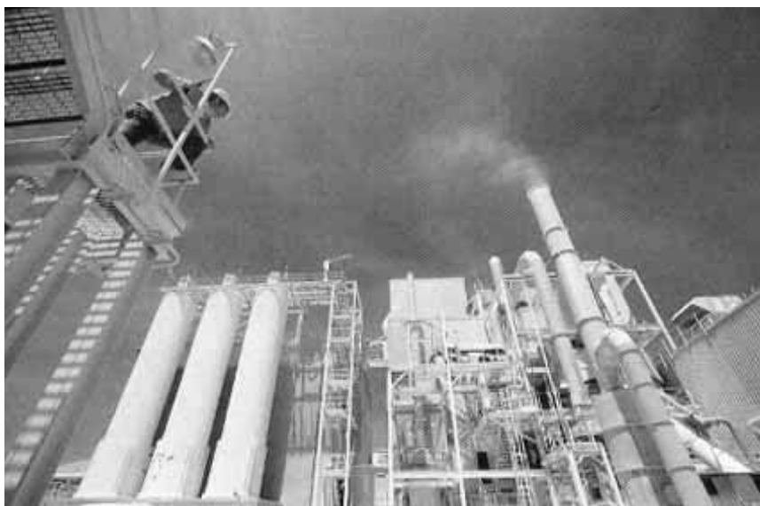
En ocasiones, un tanque de almacenamiento, una columna de destilación o un intercambiador de calor se han convertido con alguna frecuencia en reactores indeseados.
