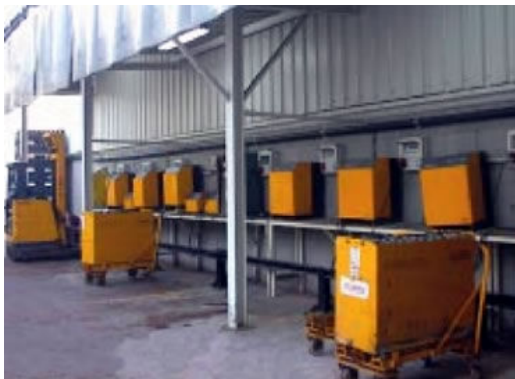
Figura 1. Local destinado a la carga de baterías (cortesía de YORKA, SA)
