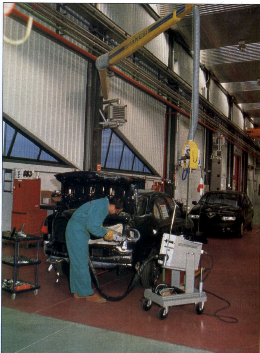
Uso de los servicios eléctricos.
