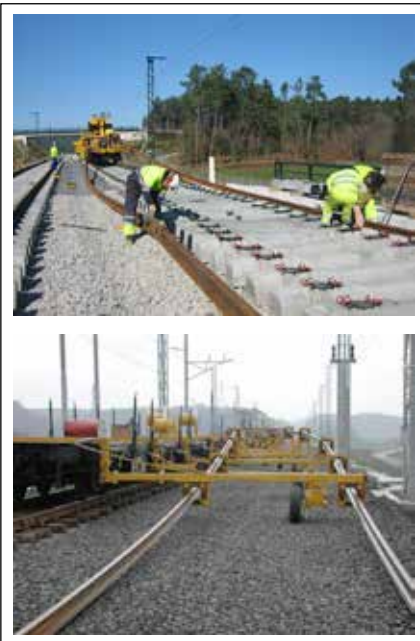
Figura 3. Descarga del carril
