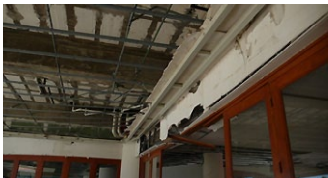
Placas de tablaroca afectadas en fachada.
