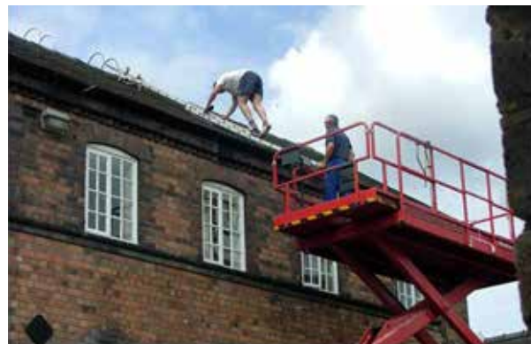
Figura 30. Uso indebido de la PEMP.
