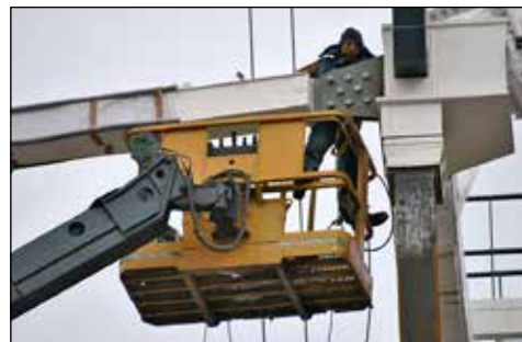
Figura 19. Operario subido sobre las barandillas.
