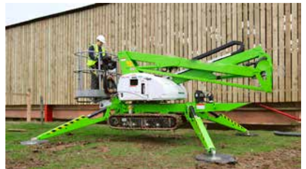
Figura 15. Estabilizadores hidráulicos con placa de apoyo.
