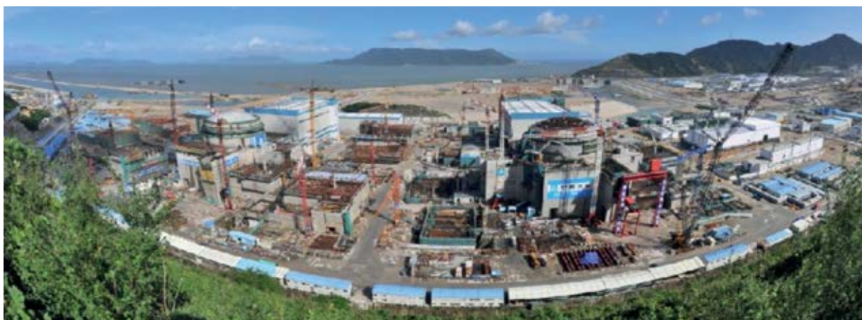
Unidades 1 y 2 del reactor EPR. Taishan, China. Agosto 2013 "AREVA" COPYRIGHT TNPJVC
