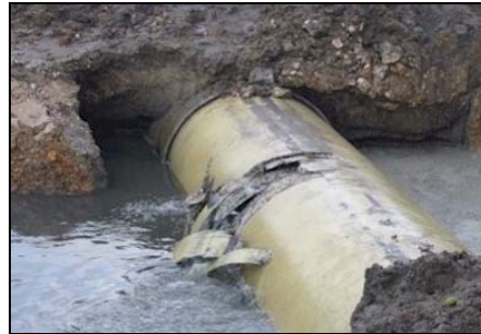
Rotura de tubería tras inundación de una zanja.
