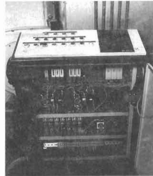
Foto 35. Cuadro eléctrico. Placa de instrucciones. Timbre de alarma
