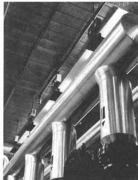
Foto 42. Riesgo de vibraciones e incendios Amarre de tuberías a techos mediante uniones de muelle para amortiguar vibraciones que podrían originar fugas de vapor por rotura de las tuberías Sistema de extinción de incendios
