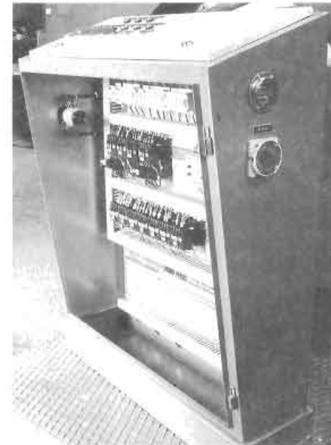
Foto 40. Señalización acústica (alarma lateral)
