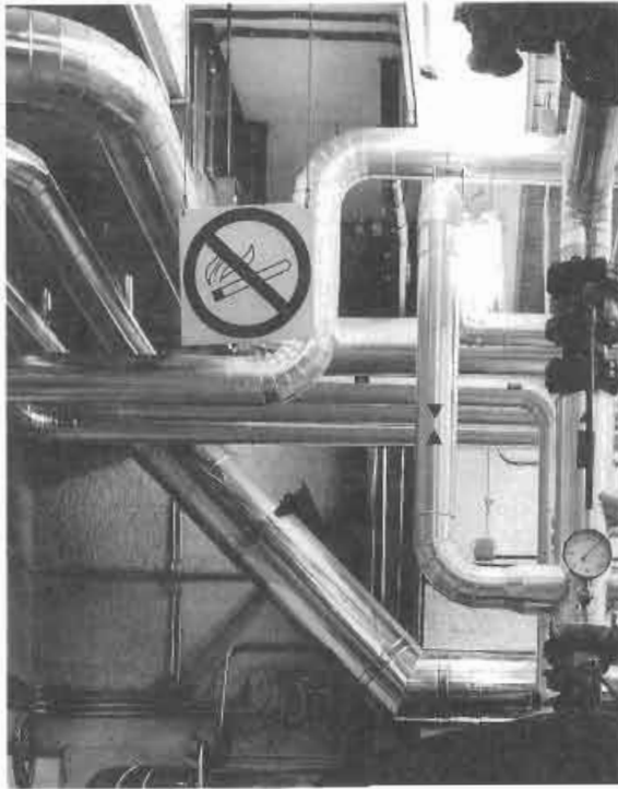
Foto 34. Señalización Tubería bidireccional (rojo -verde) Prohibición de fumar en salas con quemadores de fuel
