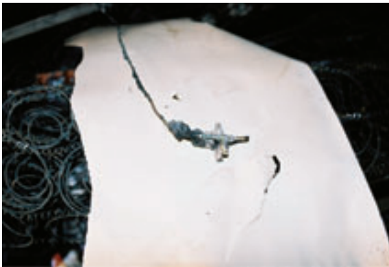
FIGURA 4.22. Ladrón o conector múltiple deteriorado por una sobrecarga que produjo un incendio posterior.
