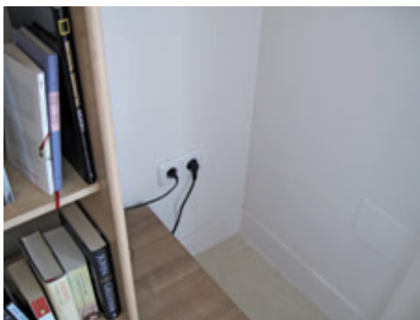
FIGURA 5.35. Tomas de corriente colocadas a 25 cm de la esquina.
