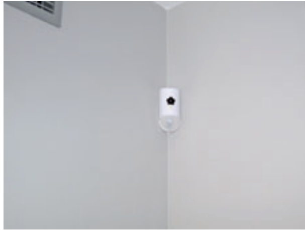
FIGURA 5.40. Detector de presencia en pasillo.
