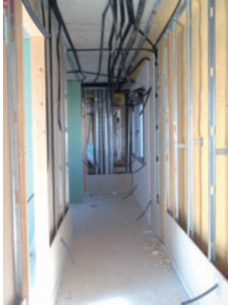
FIGURA 5.18. Instalación eléctrica en pasillo de la vivienda.
