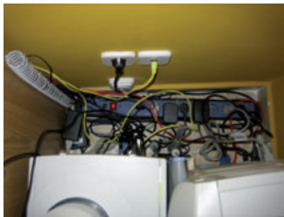
FIGURA 3.6. Toma de corriente múltiple o regleta para el servicio de equipo informático.
