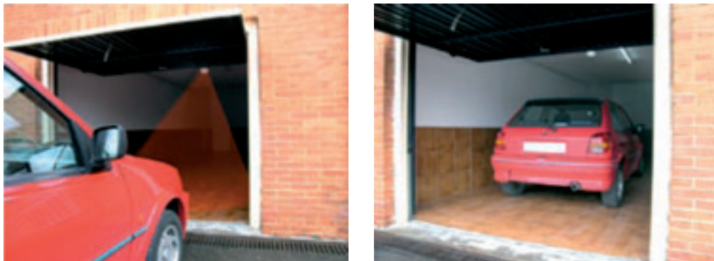
FIGURAS 5.51. y 5.52. Detector de presencia en garaje.
