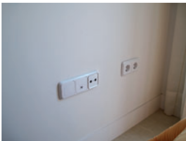
FIGURA 5.36. Tomas de corriente dobles y tomas de TV y teléfono.
