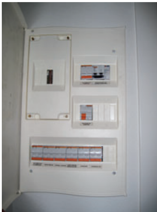
FIGURA 5.34. Huecos libres en el Cuadro General de Mando y Protección.
