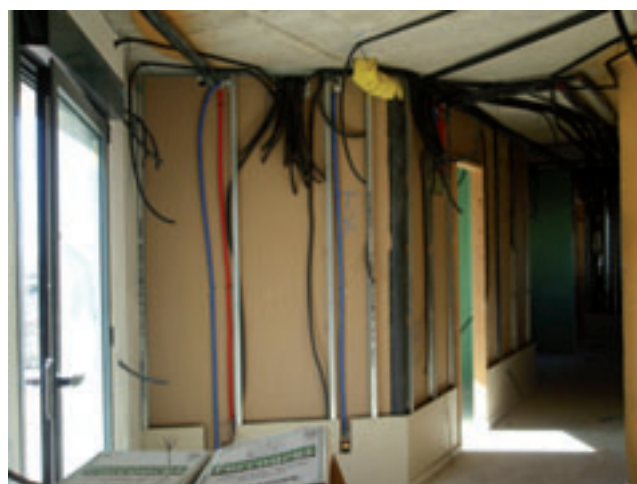
FIGURA 5.17. Detalle de la instalación eléctrica.
