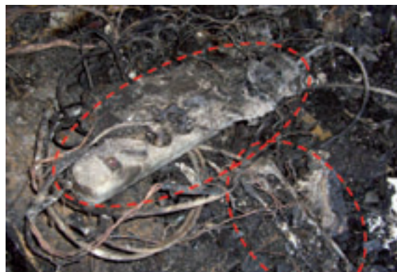
FIGURA 4.25. Regleta calcinada por una sobrecarga que produjo un incendio en la vivienda 41 .
