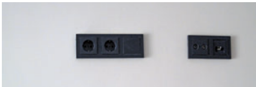
FIGURA 5.33. Zócalo Caja vacía junto a 2 tomas de corriente.
