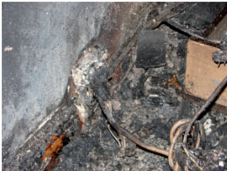
FIGURA 4.19. Cables eléctricos calcinados.
