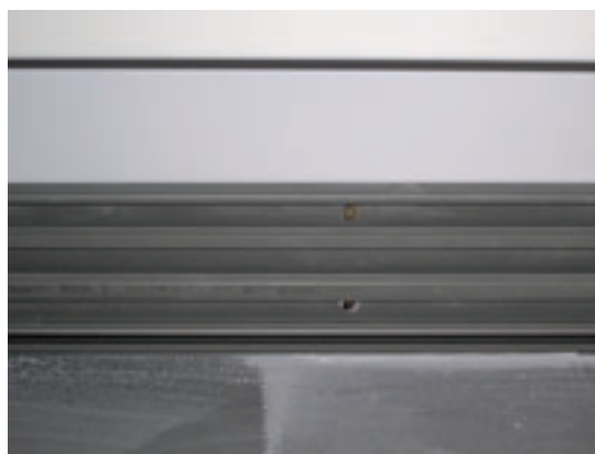
FIGURA 6.4. Detalle del zócalo portacables atornillado a la pared.
