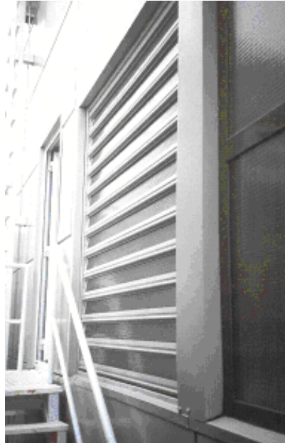
Exutorio en cubierta (interior)
