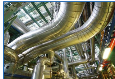
Sala de turbinas de la central nuclear de Mochovce (Chequia)
