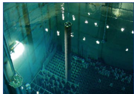
Piscina de almacenamiento
