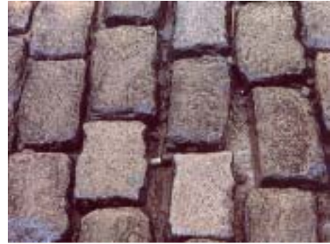
Pérdida de material de las juntas
