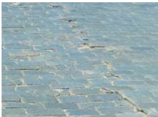
Fisuración con asentamientos
