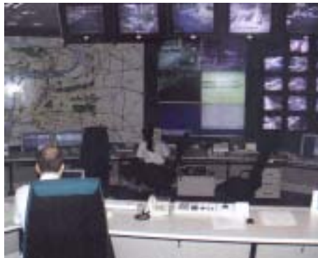
Centro de control.
