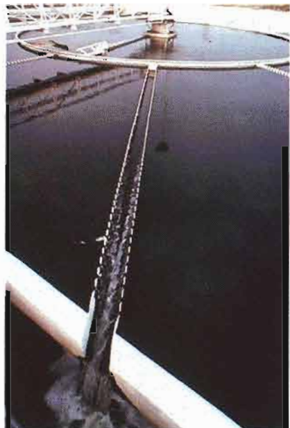
Ejemplo de eliminación de la contaminación y aprovechamiento energético y económico.
