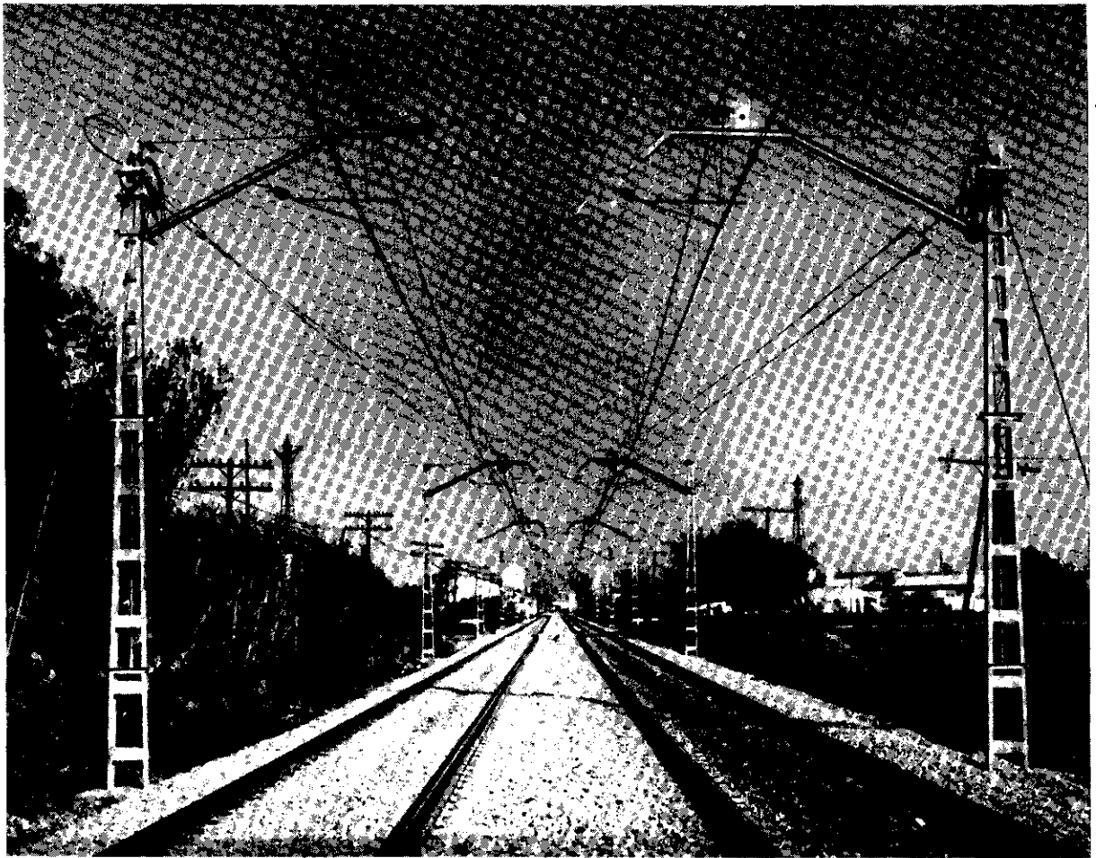
Vía doble electrificada. Atrantado de la catenaria por medio de contrapesos, para compensar la dilatación de los hilos.
