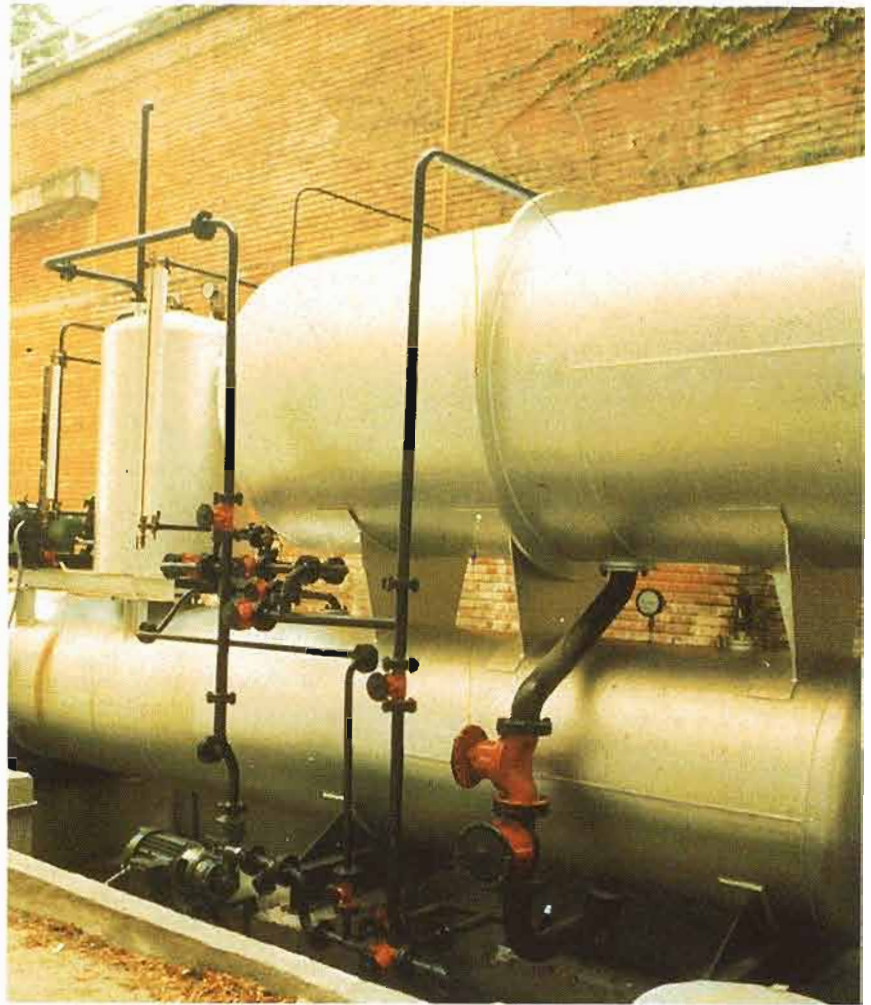
Detalle de una planta Vaclo-Vaclo de impregnación protectora de maderas.
