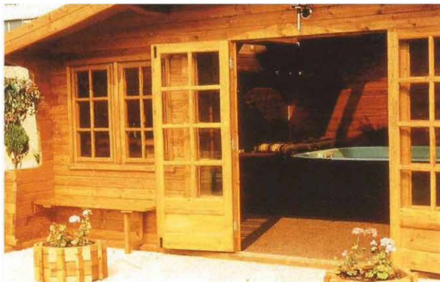
Detalle de madera tratada por impregnación química preventiva, expuesta a un alto grado de agresividad (madera constructiva de una sauna).
