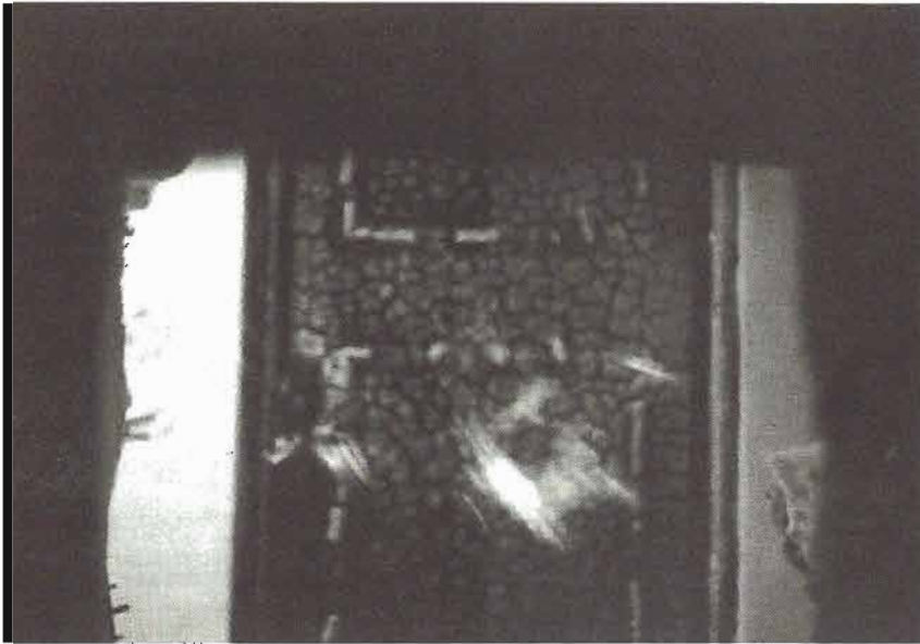
Capa carbonosa en una puerta sometida a la acción del fuego.
