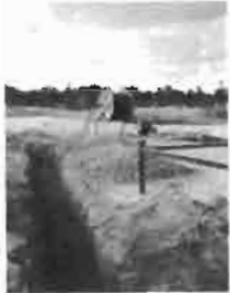
Canalizaciones y Cableados
