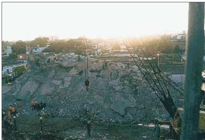
Edificio Miramar-Cumaná. Edificio sede de Seguros La Seguridad. La asimétrica distribución de la rigidez del edificio se refleja en los muros de carga que quedaron en pie alrededor de la caja del ascensor y hueco de la escalera (parte izquierda del edificio colapsado). Foto: ITSEMAP Venezuela.
