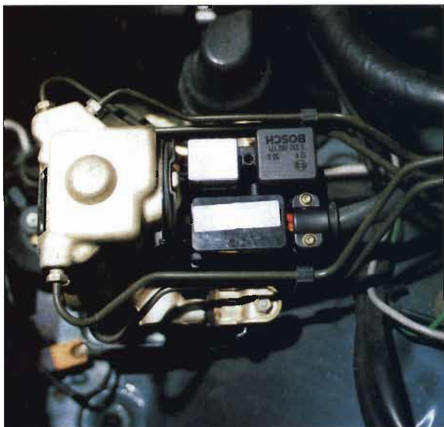
Ubicación de los relés de válvulas y bomba de retorno.
