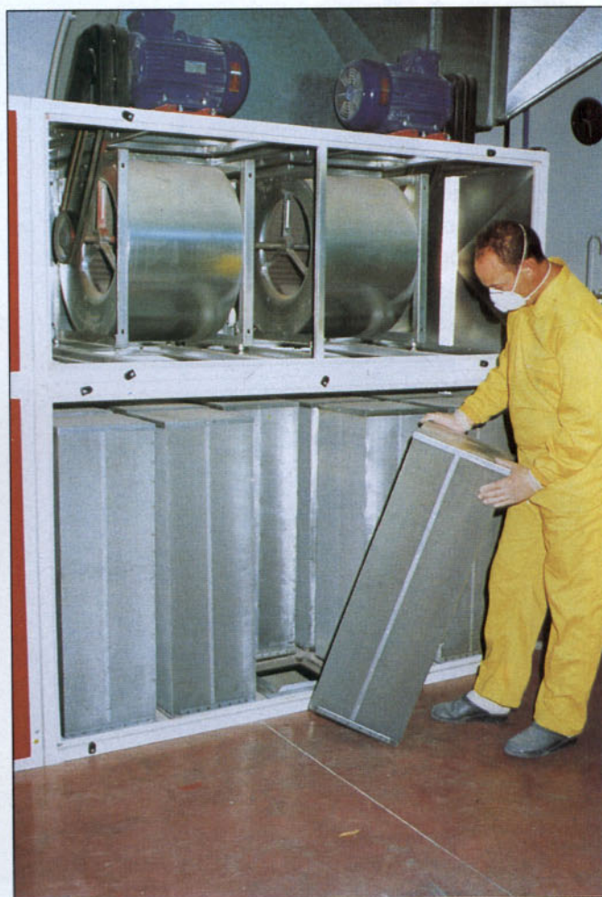
Los filtros de carbono activo reducen la emisión de disolventes (VOC's) a la atmósfera.
