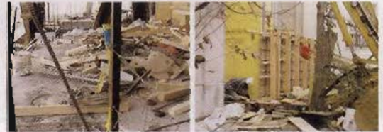
Figura 42 - Falta de orden y limpieza.
