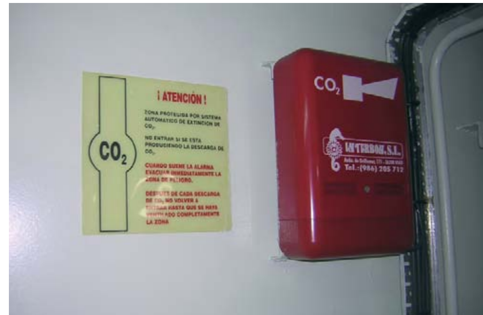
Sistema automático de extinción de incendios por descarga de CO 2
