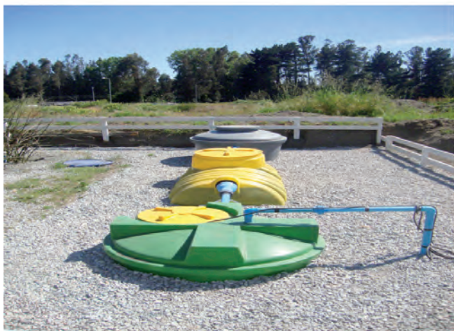
Línea tratamiento primario completa.
