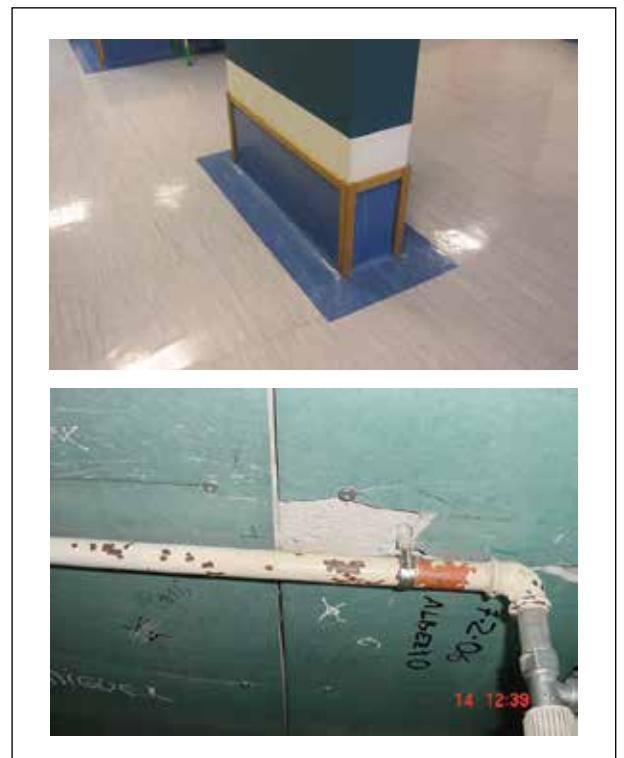
Figura 4. Ejemplos de losetas en buen estado y de losetas dañadas por uso e intervenciones de mantenimiento
