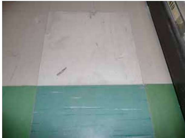
Figura 2. Ejemplo de instalación simultánea de losetas de vinilo con amianto (esquina inferior izquierda) y sin amianto (restantes)
