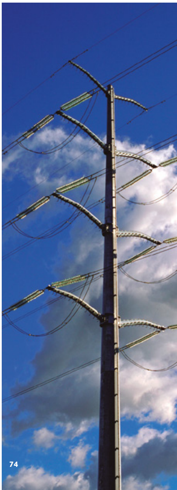
Líneas de transporte de electricidad
