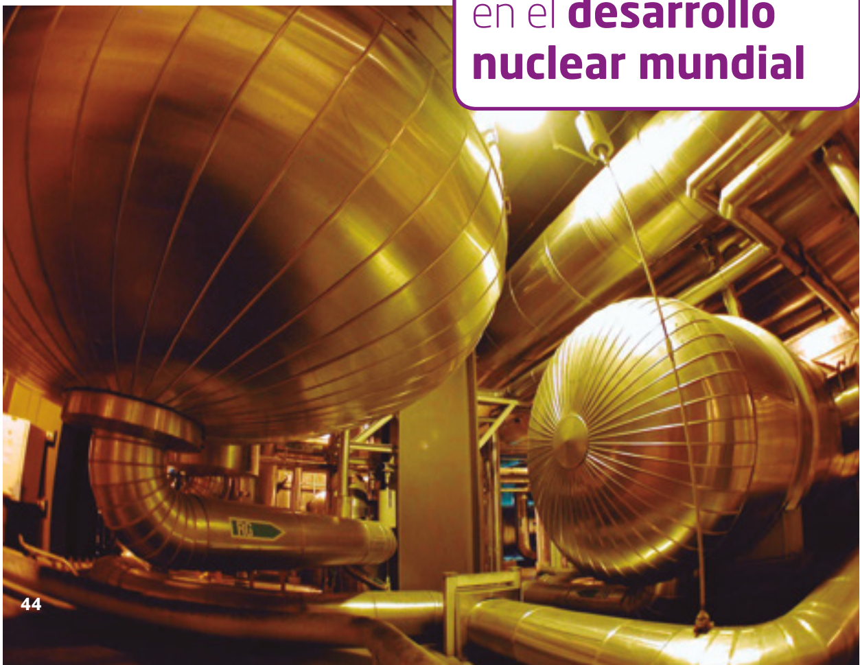
Depósitos en sala de turbinas
