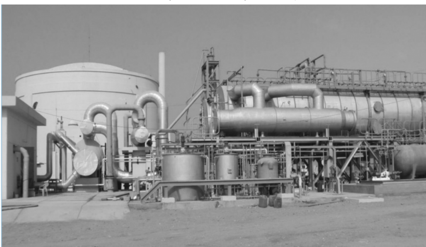
Planta desaladora de la central nuclear de Karachi, junto al mar, en Pakistán. Foto: PAEC
