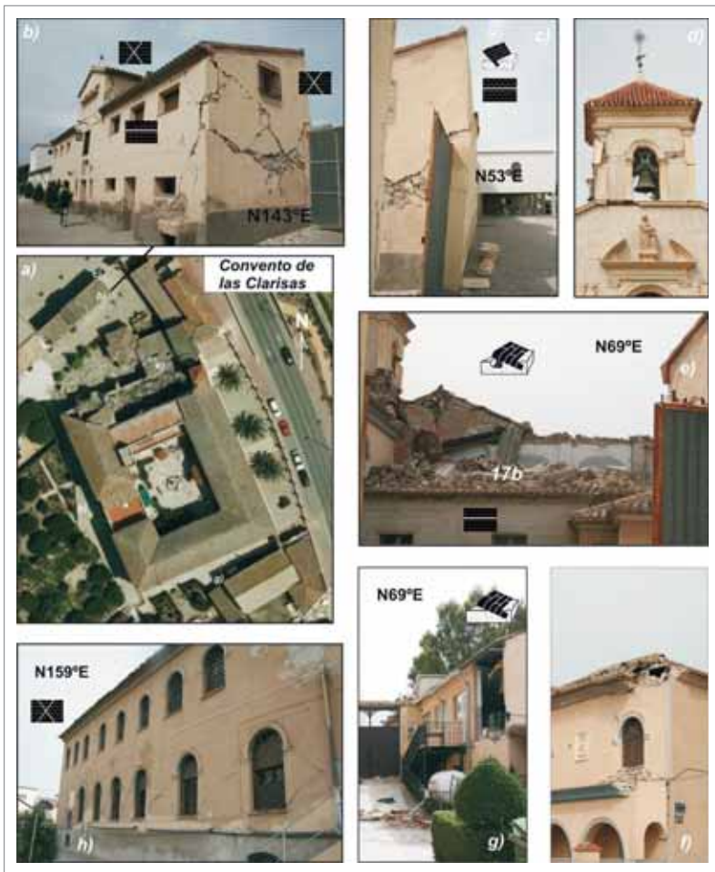
Figura 16. Daños en el monasterio de Santa Ana y la Magdalena de las Clarisas, en Lorca (Murcia). a) Vista aérea de los edificios que conforman el monasterio y situación de los daños principales. (b) y (h) Fracturas conjugadas en aspas en estructuras murarias de diferentes edificios del complejo religioso; c) Fractura y desplazamiento del muro NO en un edificio anexo a la iglesia; muros colapsados orientados en diferentes estructuras: (d) en un pequeño campanario; (e) en el muro NO de la iglesia del convento; (g) en un edificio anexo a la iglesia, y en una de las esquinas de la fachada principal (g).
