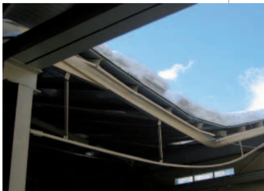
Aspecto de la cubierta parcialmente hundida.
