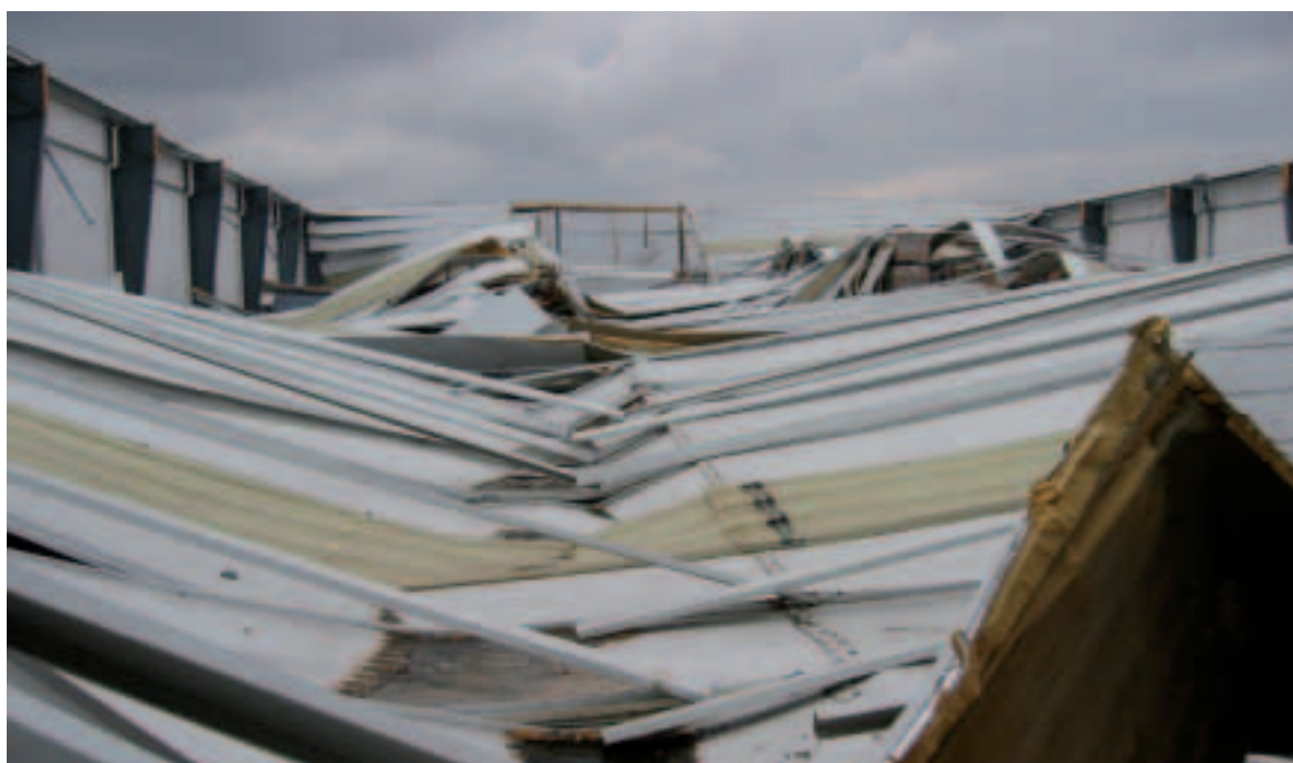
Aspecto que presentaba la cubierta hundida de la nave.
