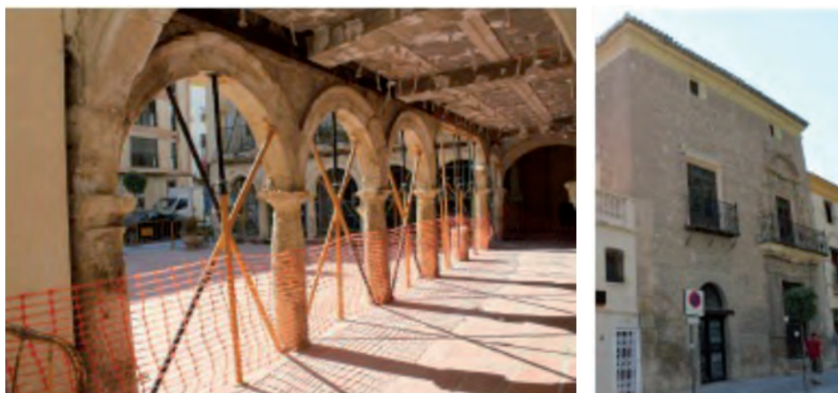
Figura 16. Daños estructurales en muros de gran espesor
