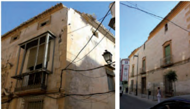
Figura 19. Intervenciones de restauración nocivas para el movimiento sísmico
