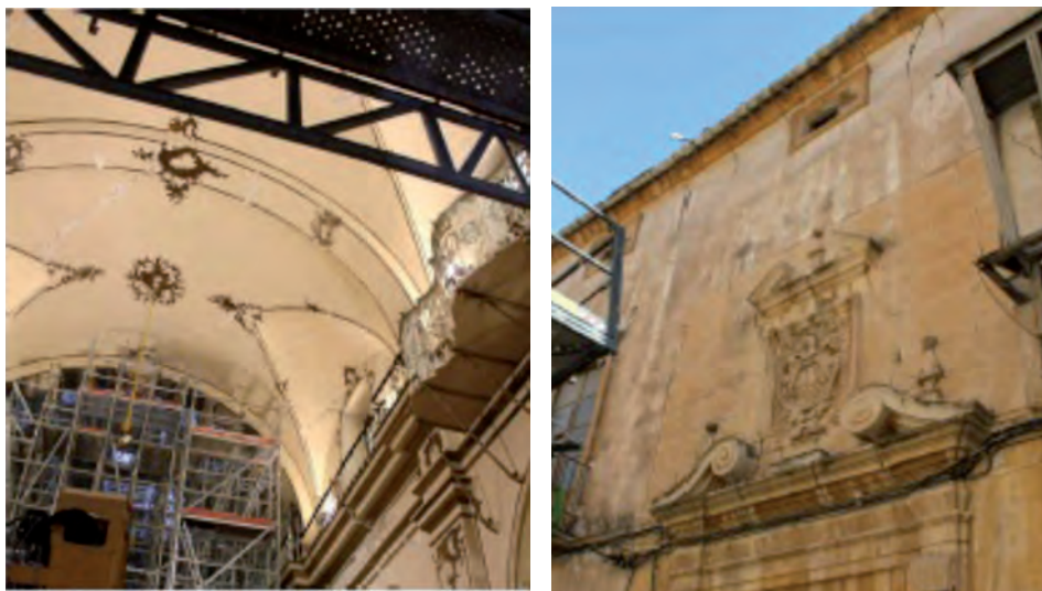
Figura 17. Daños estructurales en el conjunto histórico
