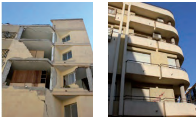
Figura 15. Daños estructurales en estructuras porticadas
